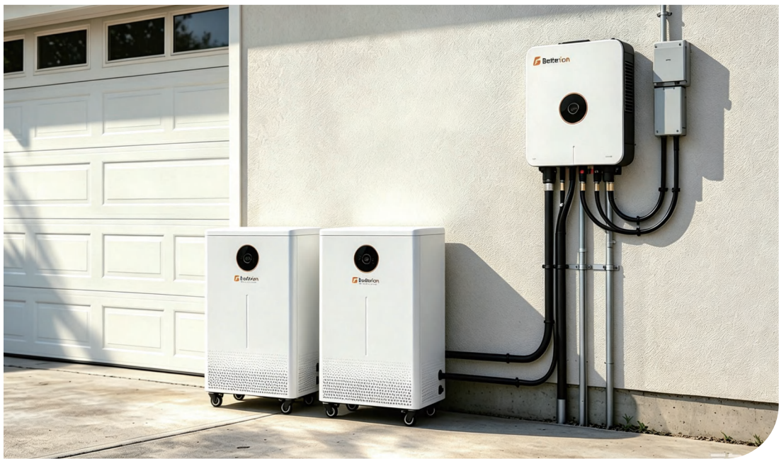
意大利 | 家用储能备电系统 10kw/20kwh | 并网 | 自给自足 | 户外安装
