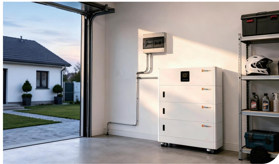
罗马尼亚 | 住宅备用电源系统 5.5kw/15kwh | 离网 | 自给自足 | 室内安装
